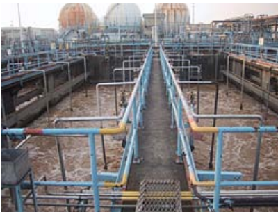
活性汚泥処理装置
