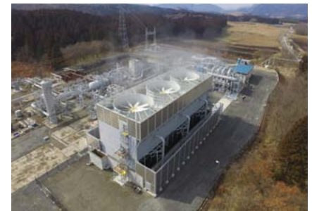
滝上バイナリー発電所の冷却塔から放出される蒸気
